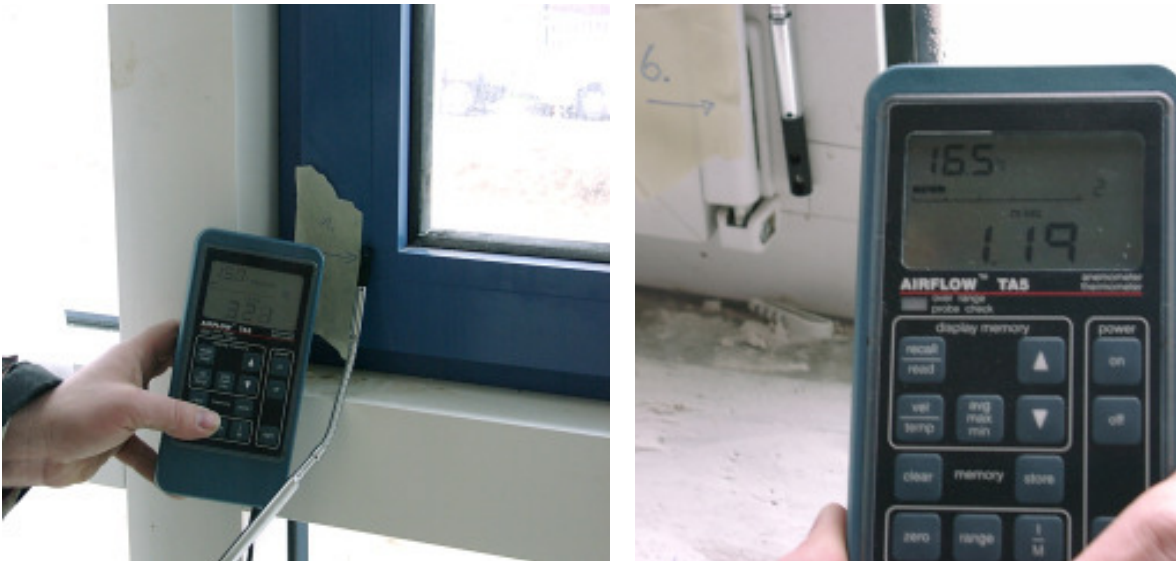
Abb. 16: Undichtheiten an den Glasleisten der Pural-Fenster. Links: Südfassade Büro EG ca. 1 m/s. Rechts: Bürofenster Südfassade 1 OG 1 bis 2 m/s.
