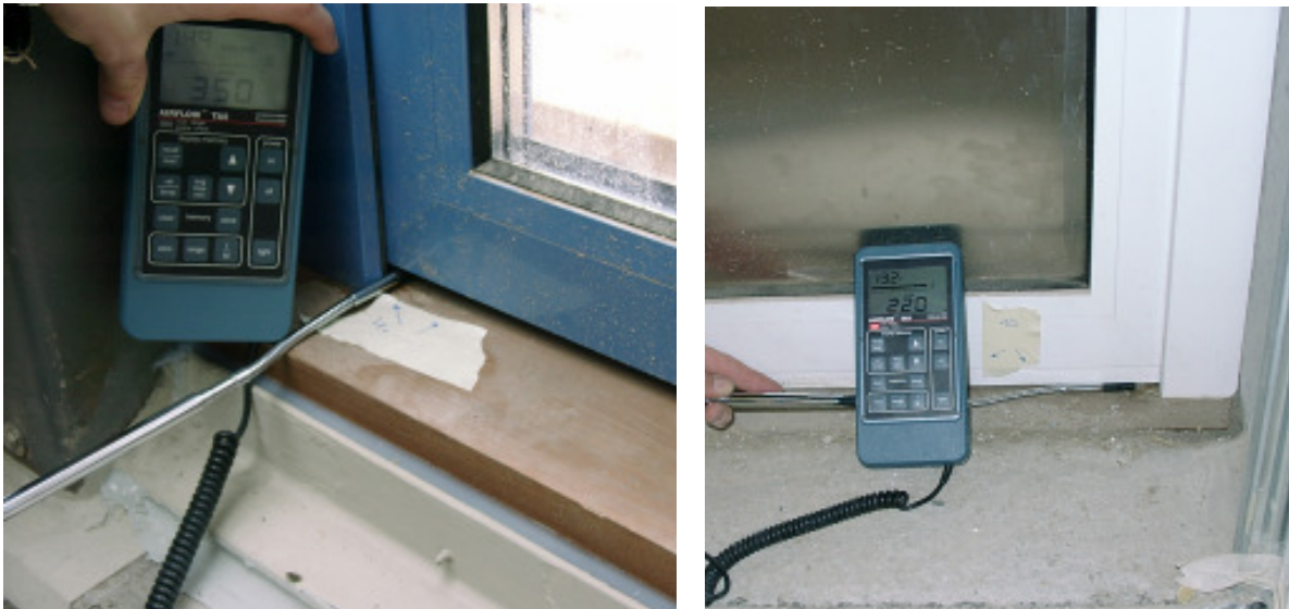
Abb. 22: Links: Türschwelle der Haupteingangstür (Südfassade) mit hoher Leckage an der Türschwelle (3,5 m/s). Rechts: Luftströmung unter der Tür mit Vakuumdämmung vom Lager EG zum LKW-Hof (2,2 m/s). Die Abdichtung mit einer sog. „Kältefeind“-Bürstendichtung ist offensichtlich nicht ausreichend.
