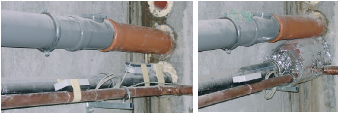
Abb. 61: Kaltwassertemperaturmessung am Eintritt der Hauptkaltwasserleitung (schwarzes Rohr) in das Gebäude. Im Bild zum einen der ungedämmte Zustand mit temporärer Fixierung von Elektronik und Sensor sowie der endgültige Zustand mit gedämmten Sensor (Anlegefühler).
