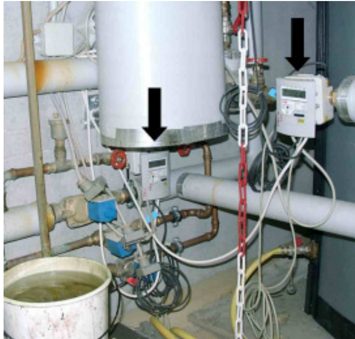
Abb. 47: Zwei Wärmemengenzähler (Pfeile) im 1.OG der Produktion im Bereich der Pufferspeicher und des Wärmetauschers der Trinkwarmwasserbereitung für die Produktion.
