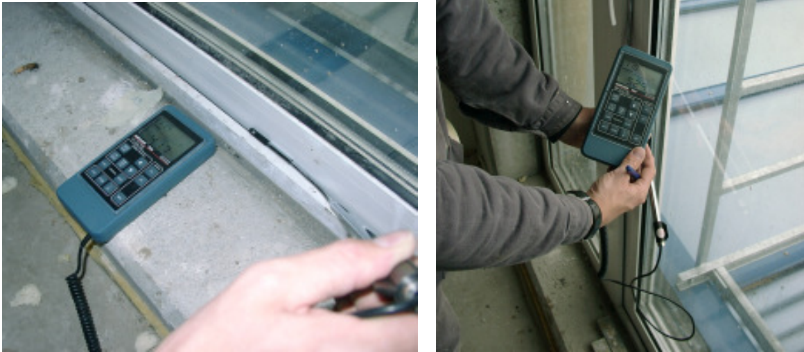
Abb. 21: Undichtheiten an zwei Fenstertüren (Beispiele) im Labor (Westfront). Links: Leckage am unteren Bereich (4,2 m/s). Rechts: Leckage an der Beschlagseite der Tür (5,3 m/s).
