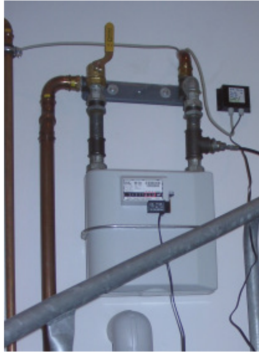
Abb. 45: Gaszähler im Wendeltreppenhaus im 2. OG (Labor Ebene) für den Gasverbrauch des Heizkessels. Unter dem mechanischen Zählwerk ist der Impulsgeber montiert, welcher mit einem Kabel mit dem Impulszähler und M-Bus-Umsetzter verbunden ist (schwarzes Kästchen rechts oben im Bild).
