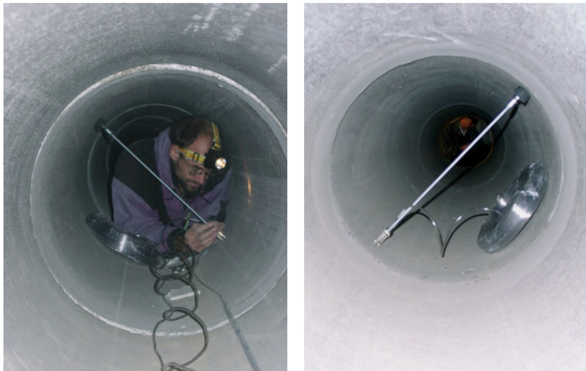
Abb. 56: Links: Montage eines Druckaufnehmers in einer der fünf Betonröhren des ERWT (Durchmesser 600 mm). Rechts: Fertig montierter Druckaufnehmer mit dem noch nicht abgewickelten Schlauch.
