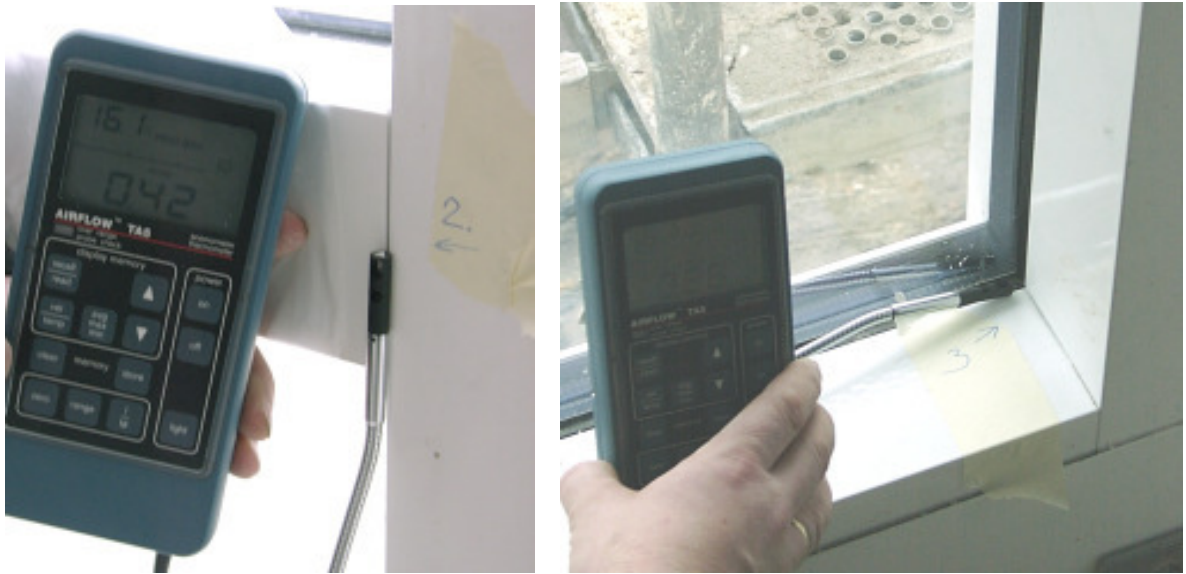
Abb. 18: Links: Leckage an einer typischen Stoßstelle der Pfosten-Riegel-Konstruktion, hier Südfassade Bürotrakt EG. Rechts: Undichtheit bei einer Anschlussscheibe an die Pfosten-Riegel-Konstruktion
