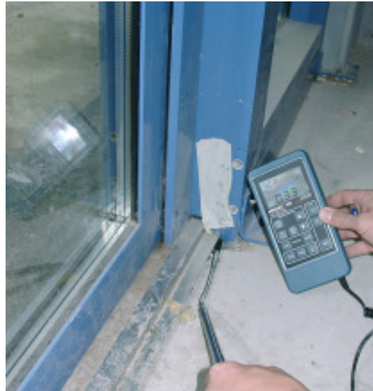
Abb. 23: Kleinere Undichtheit an der Treppenhaustür in der Nordfassade zwischen Produktion- und Lagertrakt zum LKW-Hof. Hier konnte unter der Edelstahl-Türschwelle auf der ganzen Breite ein Luftstrom gemessen werden (um 0,3 m/s). Zwischen Tür und Schwelle war der Anschluss aber ausreichend dicht.
