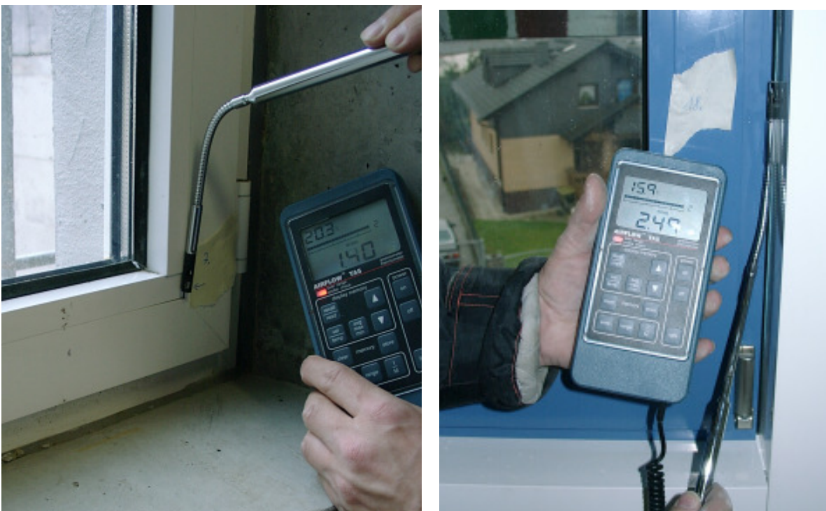
Abb. 17: Links: Undichtheiten an der Glasleiste des Pural-Fensters im EG Nordfassade/Produktionstrakt. Rechts: Anschluss des Fensters im 2. OG Südfassade (Bürotrakt) auf der Beschlagseite (2 bis 3 m/s). Die gleiche Schwachstelle wurde an den Fenstern auf der Nordseite festgestellt.
