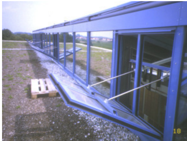
Abb. 123: Geöffnete Rauchabzugsklappen an der westlichen Atriumverglasung (Blick vom Dach über dem Laborbereich).
