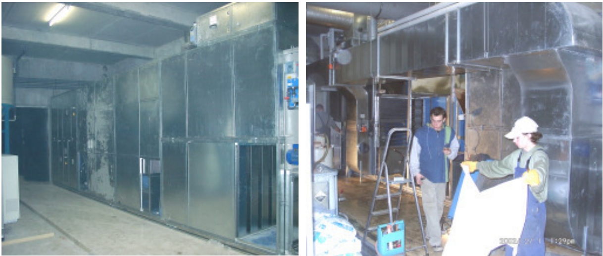
Abb. 94: Lüftungsanlage im Technikkeller vor der Fertigstellung noch ohne angeschlossene Luftkanäle (links) und am 1.2.2002 beim Einbau der beiden neuen Wärmeübertrager (rechts).
