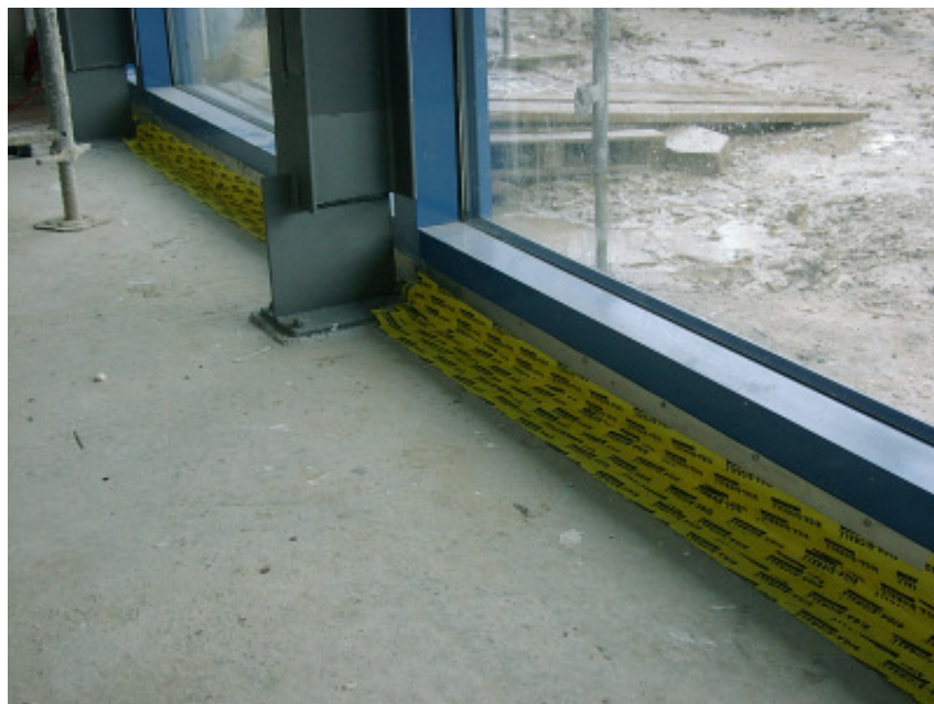
Abb. 19: Anschluss Pfosten-Riegel-Konstruktion an die Beton Bodenplatte mittels EPDM-Lappen und Spezialklebeband an der Ostfassade im Bereich der Cafeteria. Hier wurden aufgrund nicht verklebter Bereiche vereinzelt Undichtheiten festgestellt.
