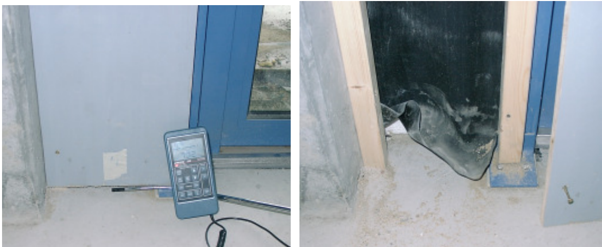
Abb. 26: Leckage durch zum Boden nicht verklebte Folie hinter der Holzverkleidung im nördlichen Treppenhaus. Erst nach Demontage der Verkleidung (rechts) ist die Ursache zu erkennen.
