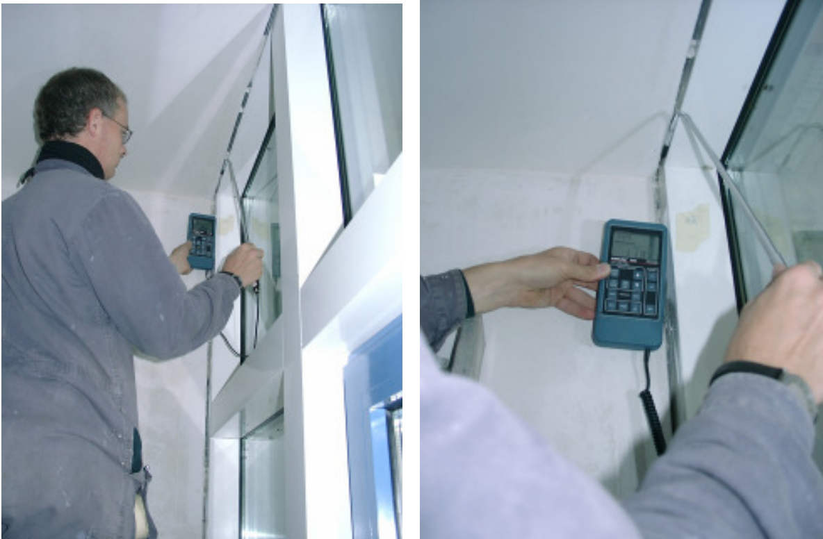
Abb. 20: Die fehlende luftdichte Verbindung zwischen Pfosten-Riegel-Konstruktion und der Decke im 2. OG Südfassade (Bürotrakt) zeigt auf der ganzen Länge des Bauteils bedeutende Leckageströme (1 bis 2 m/s). Das rechte Bild zeigt einen Detail des linken Bildes.
