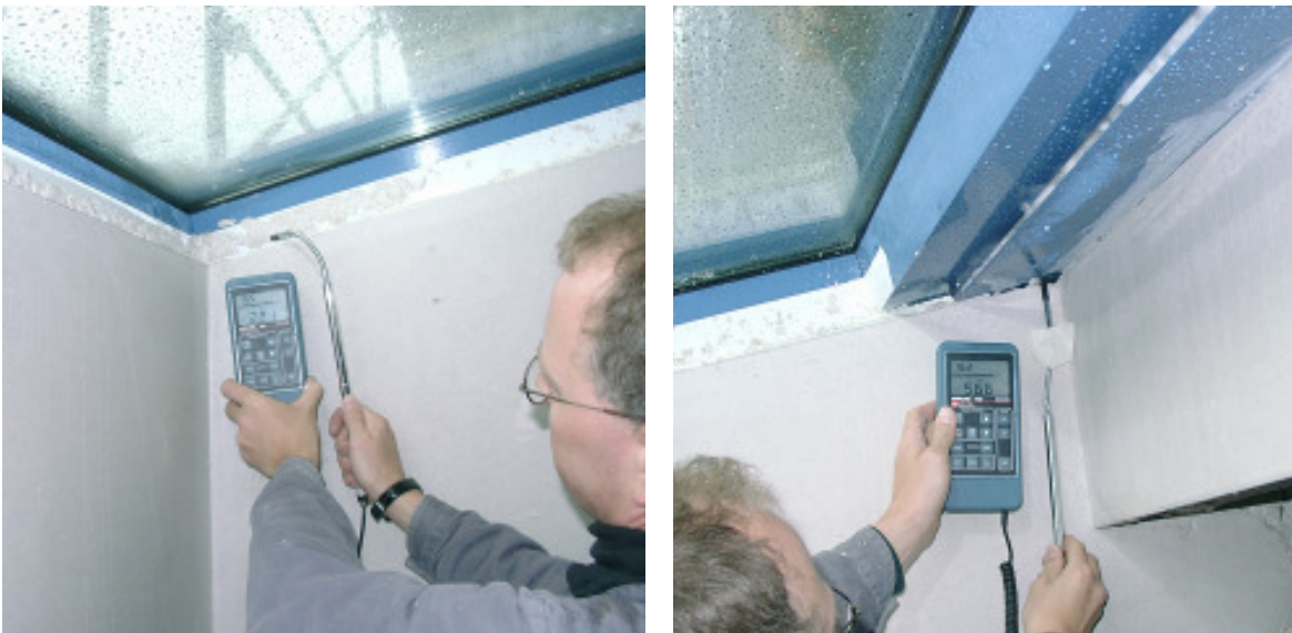
Abb. 24: Links und rechts: Die Anschlüsse der Festverglasung (Oberlichter) in den Seminarräumen an den Baukörper zeigen stellenweise Leckagen (Strömungsgeschwindigkeiten über 5 m/s)
