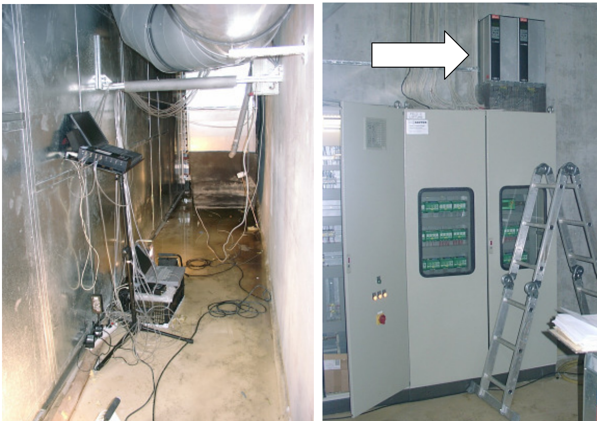
Abb. 57: Links: Messaufbau zur gleichzeitigen Kalibrierungsmessung der insgesamt sechs Druckdifferenzen hinter dem Lüftungsgerät im Technikkeller. Eingesetzt wurden zwei Laptops und zwei Mehrfachdruckmessdosens. Hinten in der Mitte befindet sich der Frischluftkanal (helle Fläche). Rechts: DDC-Steuerschrank der Lüftungsanlage. Oben über dem Schaltschrank befinden sich die beiden Frequenzumformer zur Ansteuerung der Ventilatormotoren (Pfeil).
