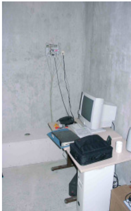
Abb. 42: Messtechnikraum im Keller in dem sich auch das M-Bus Zentralgerät befindet. Im Bild sind der PC mit Modemverbindung, die USV (Unterbrechungsfreie Spannungsversorgung) und das Hauptnetzteil zur Spannungsversorgung der Temperatursensoren (Gehäuse an der Wand, geöffnet).
